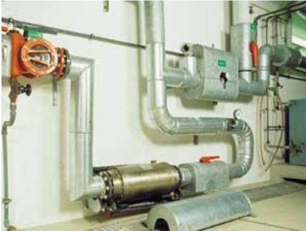
Bild 2: Permanentmagnetisches Wasserbehandlungsgerät "permasolvent" (Quelle: permatrade).
